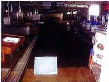
施工前の様子。魚等の油により滑りやすくなった場内
