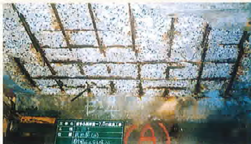
■ 床版破傷状況(剥離・鉄筋露出)ランクA
