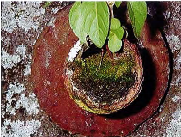
完全に詰まってしまい、既に配水管の役割を果たせなくなった状況
