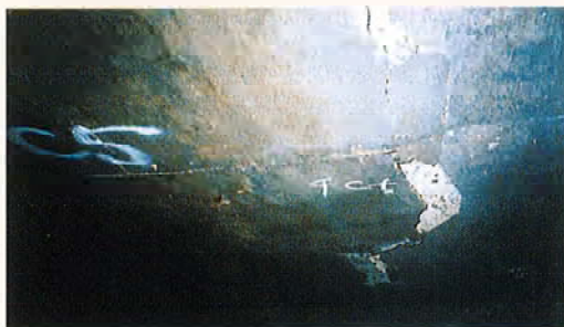
■ 床版損傷状況ランクB
