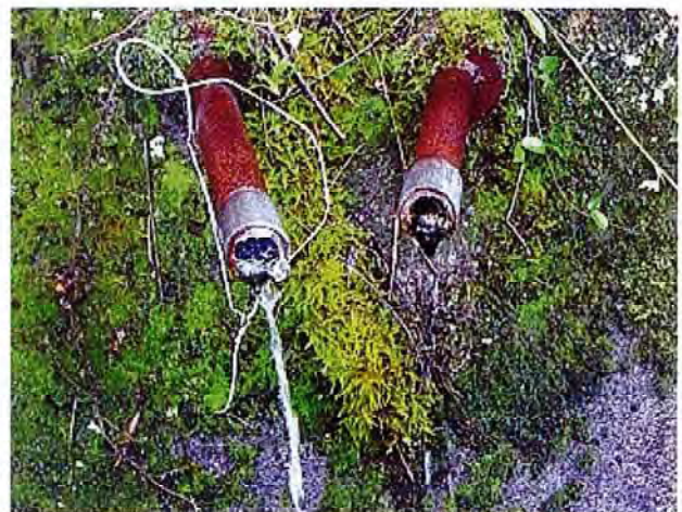
雨が排水されているもの（左）と、管内が詰まってしまい機能できていない配管の様子
